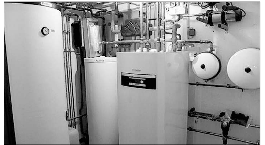
Dank modernster Heiz- und Haustechnik kann der Energieverbrauch auf ein Minimum reduziert werden.
